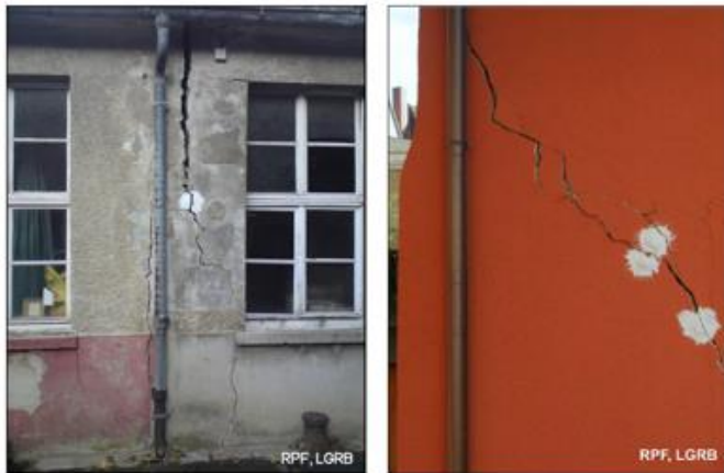
Hebungsrisse an Gebäuden in Staufen im Breisgau (Quelle: LGRB)
