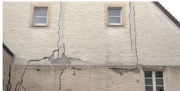
(Geothermie-geschädigtes Haus in Staufen)
